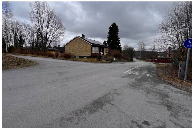
Gång- och cykelväg är ej separerad längs med Bergstäcksvägen.
